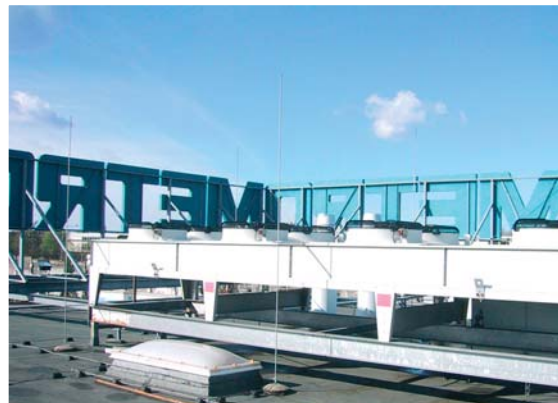
Die strombetriebenen Kühlaggregate auf dem Dach eines Metro-Großmarktes
